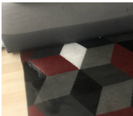
Zentimeterhoch stand das Wasser in der Wohnung der Familie J. nach dem verheerenden Wasserschaden in Folge eines Unwetters im Sommer 2020
